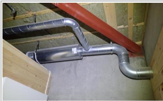
Ventilasjonsanlegg i boder og tekniske rom under boligseksjon sør.
