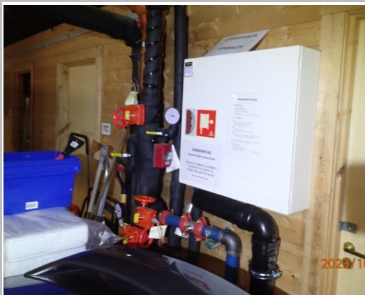
Parkeringskjeller med brannslageskap og hovedstoppegran. Her er også åpningsventiler for sprinkelanlegg. Anlegget skal ha årlig kontroll.
