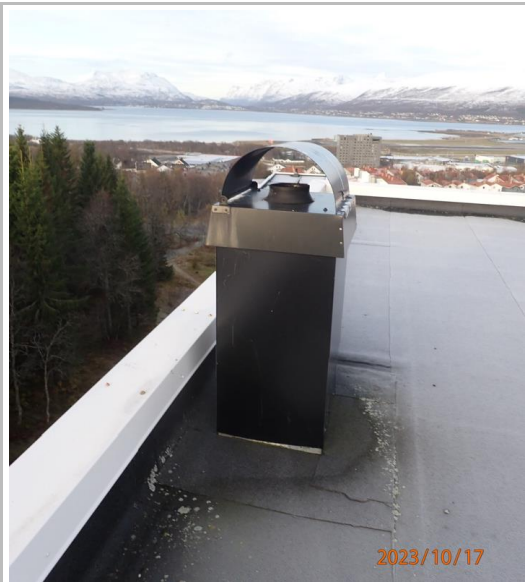
Øvre leilighet har montert ildsted og pipe.
