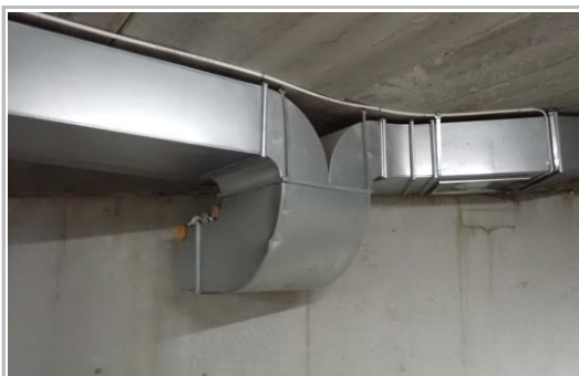
Ventillasjonsanlegg i parkeringskjeller i blokk nord.
