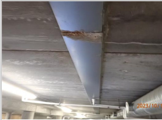
Innvendig spesialbygget takrenne i parkeringskjeller nord. Årsaken til vann inn fra huldekker kan være både utett yttertekke, men kan også skyldes kondensering.
