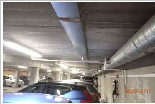
Innvendig i parkeringskjeller i bygg nord. Her er det montert flere innvendige takrenner med bedløpsrør for å hindre lekkasje fra hulldekker og ned på parkerte biler. Usikker på om lekkasjen er utett yttertekke eller kondensering.
